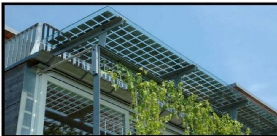
شکل (۳-۷): نصب آرایه‌های فتوولتاییک به عنوان سایه‌بان
